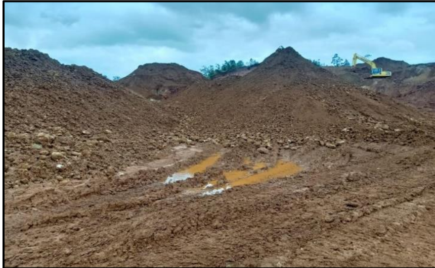
Gambar 3. Genangan Air pada Stockpile
